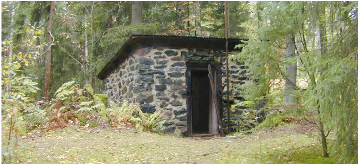
40 Sprängmedelsförrådet år 2003. Dörren var vid detta tillfället skadad i upphängningen. Detta har av allt att döma sedan dess åtgärdats varför skadan ej redovisas ytterligare i vårdplanen.
