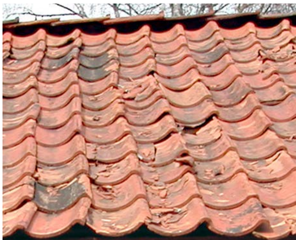
65 Drivmedelsförrådets taktegel är kraftigt frostsprängt åt sydsidan.
