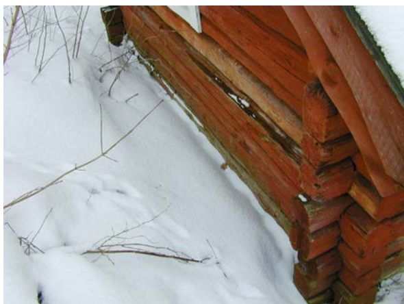
69 Byggnadens södra gavel ligger i anslutning till en kraftig slänt vilket riskerar att göra syllen utsatt för fuktproblem till följd av vattenavrinning längs marken.
