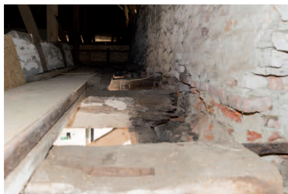
Bjälklagets ändar som vilar på den östra muren har stora rötskador där nästan hela angöringen är borta. (D2015-1061)
