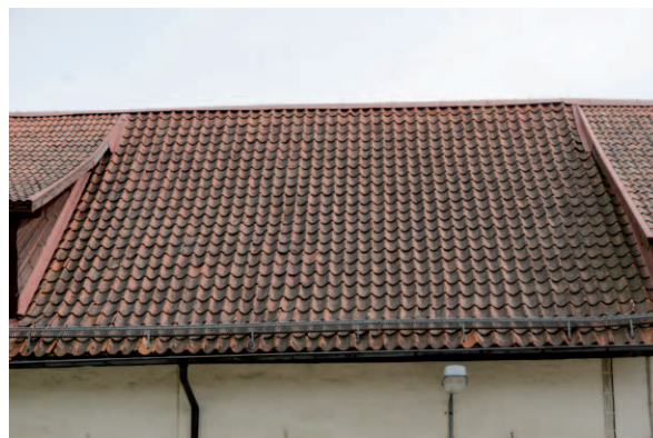
Enstaka pannor har skador efter frostsprängning. (D2015-1045)
