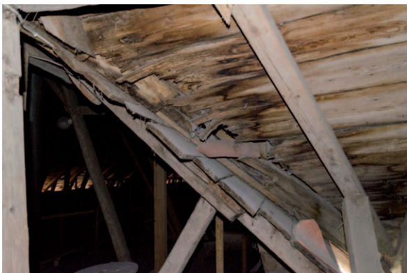
Innertaket i vinkeln mellan den västra och norra längan har spår efter gamla fuktskador. (D2015-1066)
