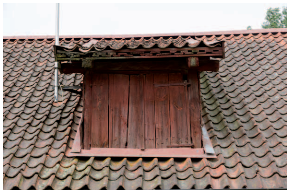
Plåtarbeten runt en av takkuporna där plåten satts över luckorna. Dett bör åtgärdas i samband med renoveringen. (D2015-1070)
