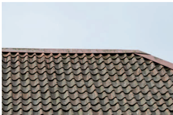
Nockplåten vid det nordvästra hörnet där vinkeljärn saknas. Nockplåten är i behov av ommålning. (D2015-1071)
