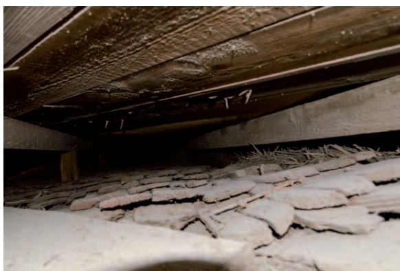
Den ursprungliga taktäckningen med stickspån är synlig genom ett hål i undertaket nära takvinkeln. Notera även halmen till höger i bild. (D2015-1064)
