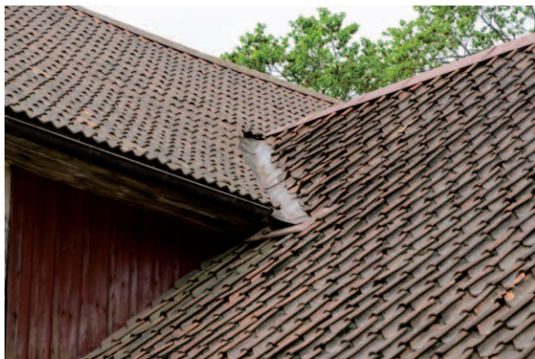
Vinkelränna vid mötet till den höga södra delen. Denna är av en storlek som betydligt bättre smälter in i takfallet. (D2015-1073)
