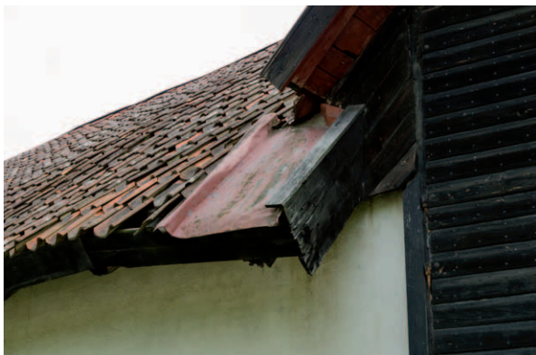
Det nedåtlutande partiet vid den södra änden som bör undersökas närmre. (D2015-1020)
