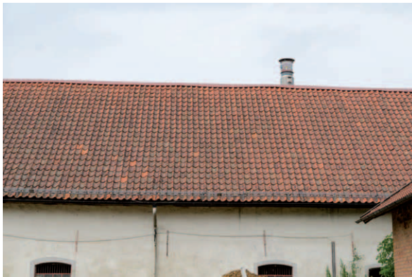
Flera pannor har bytts ut och skiljer sig i färg mot de övriga. (D2015-1041)
