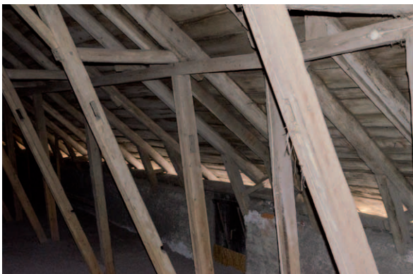
Spår finns i takstolarna efter tidigare konstruktioner. (D2015-1067)
