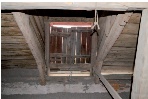
En av takkuporna sett från det mittersta vindsutrymmet. (D2015-1063)
