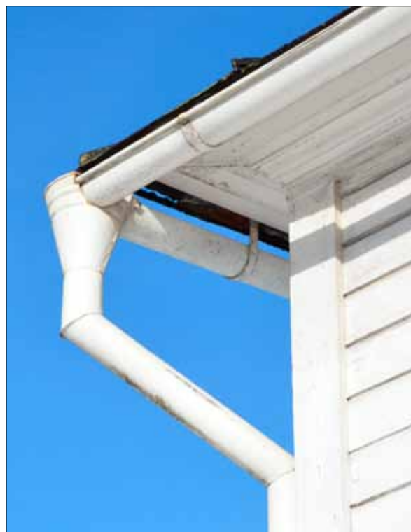
56 Stuprör av äldre modell på hus 5 (Slm D2014-320).
