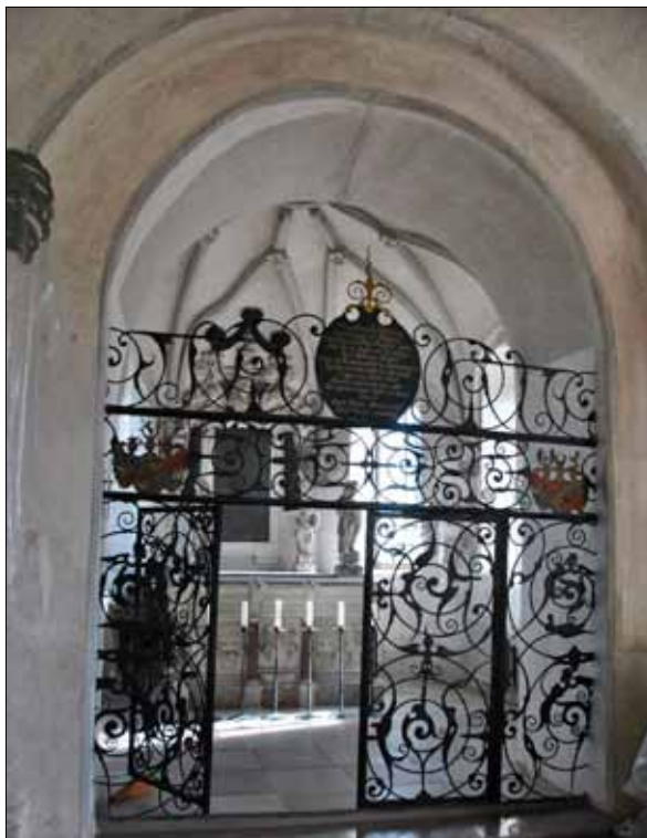
22 Sättningssprickan före åtgärd. (Slm D2014-594).
