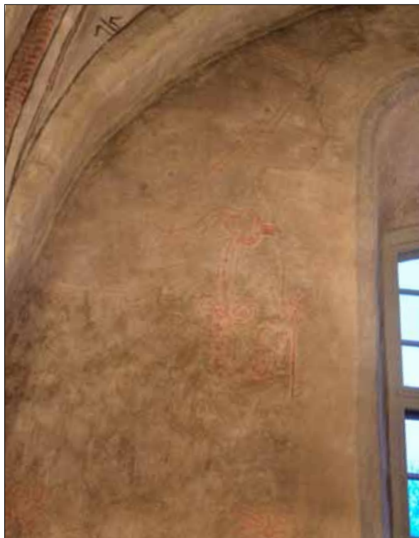
9 Långhusets norra vägg före rengöring (Slm D2014-582).
