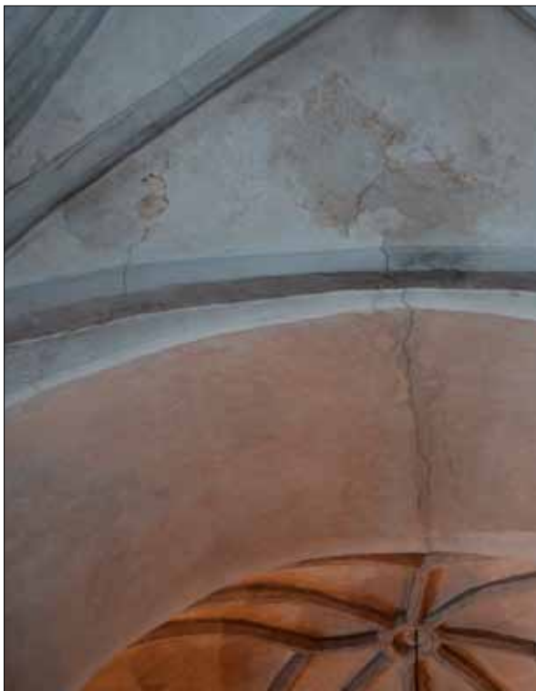
21 Sättningsspricka samt fuktfläckar i gravkoret före åtgärd. (Slm D2014-593).
