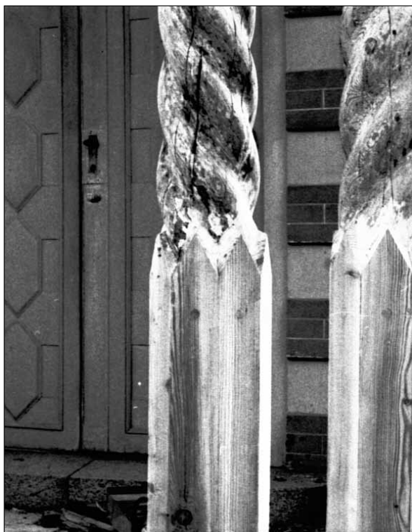
20 I augusti år 1995 åtgärdas rötskadorna på kolonnernas nederstycken (basen) genom träbyten. Foto Magnus Josephson (SLM-S43-95-4).
