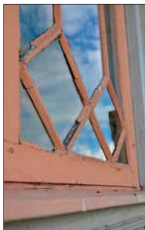
27 Fönsterkitt har torkat ut och fallit bort (Slm D2013-649).
