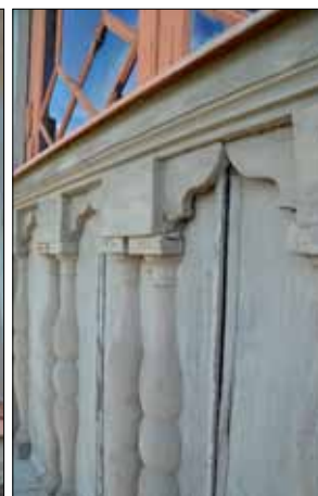
28 Större springor finns här och var mellan stående panelbrädor. (Slm D2013-650).
