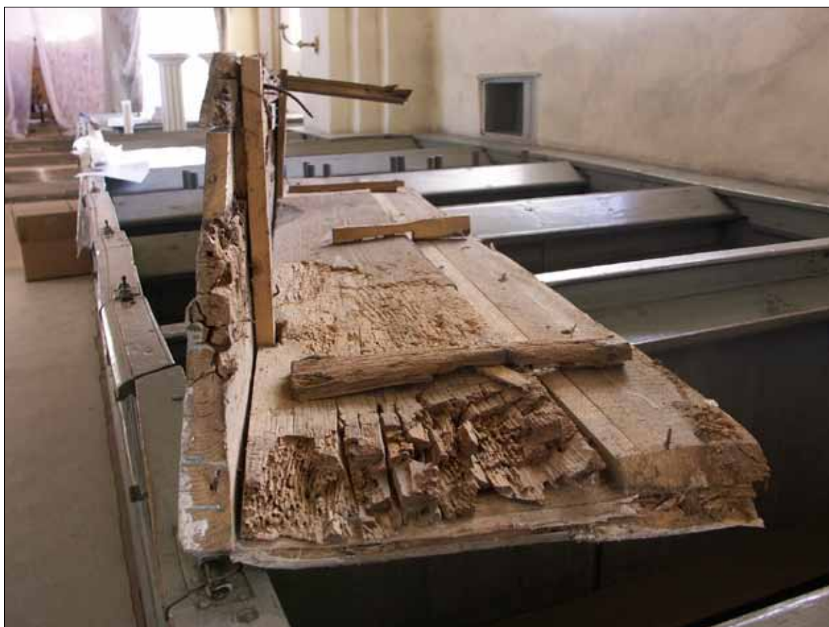
19 Bänkarna var rötskadade i änden som varit placerad mot ytterväggen. Östra bänken (D12-0316).
