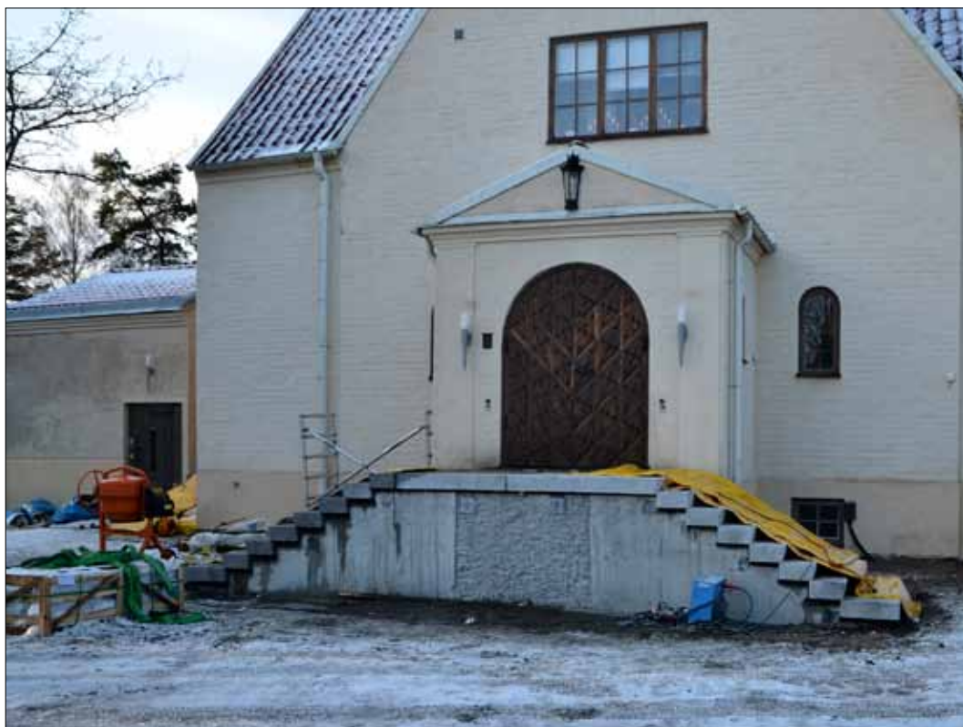
19 Felaktigt utförd gjutning innebär bland annat att trappans steghöjd varierade vilket utgjorde en kraftig snubbelrisk (Slm D13-0078).
