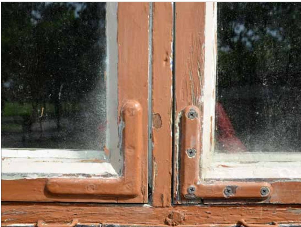
29 På såväl fönsterkarmar som fönsterbågar fanns spår efter en relativt mörk fernissa direkt på träet, här på karmen mellan fönsterbågarnas vinkeljärn (Slm D13-0140).
