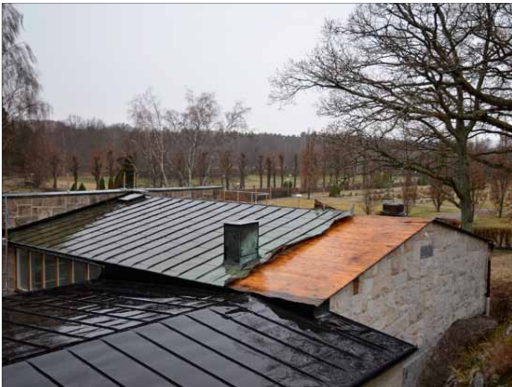
13 Kapellets södra takfall efter stölden av kopparplåt (Slm D13-0124).
