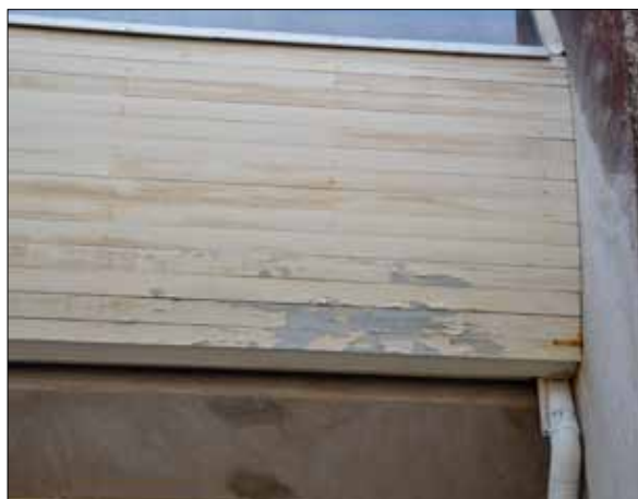
36 Panelen är både fukt och rötskadad (Slm D13-510).
