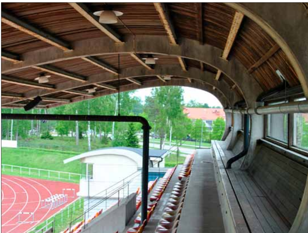
14 Vy inifrån läktaren mot väster. I bild syns takavvattningssystemet med stuprör som leder ned takfallets regnvatten. Det bakre horisontella uppsamlingsröret är nyligen utbytt mot ett plaströr med många länkande rörskarvar. Foto: Eva Wockatz (Slm D13-489).
