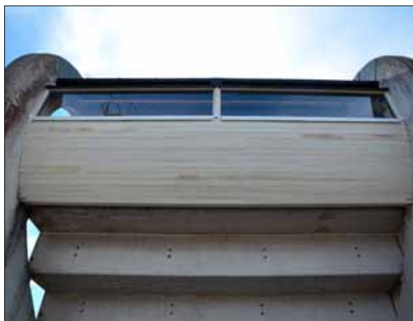
38 Plåtavtäckningen kring fönstren är oestetiskt utförd (Slm D13-512).
