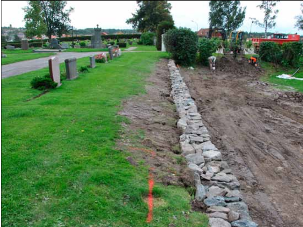
6 Terrassmuren efter åtgärd. Den ovanliggande marknivån har planats ut något (Slm D11-709).
