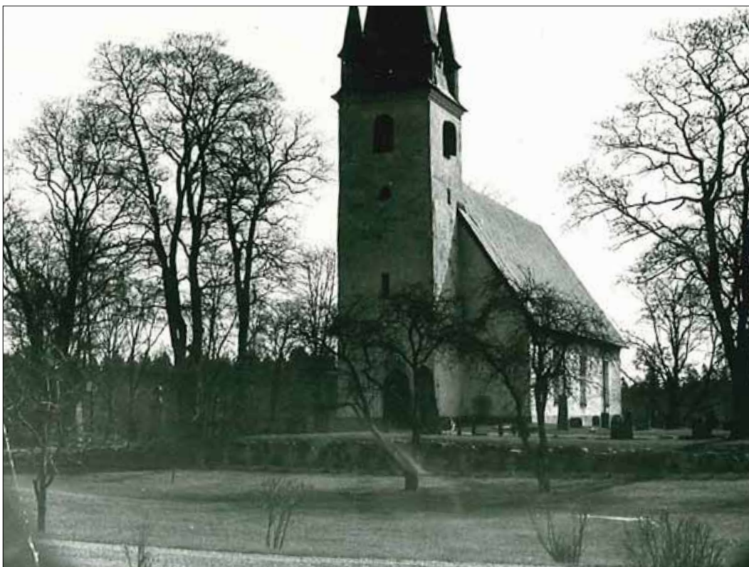
3 Denna bild är tagen efter 1940 då kyrkan fick nytt koppertak. Häcken är här borta och muren förefaller vara skadad. Foto: Okänd (Slm 11-706)
