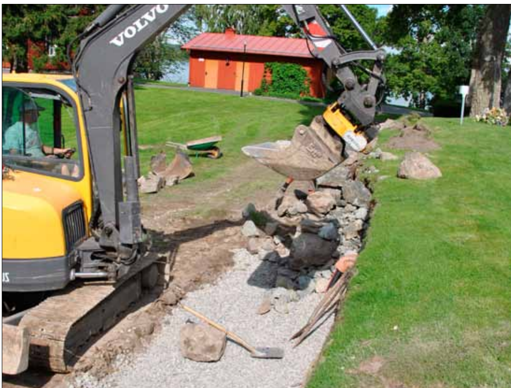
5 Grundläggning av helt raserade partier av muren, notera dagvattenledningen vars utlopp tidigare var placerat i muren (Slm D11-708).
