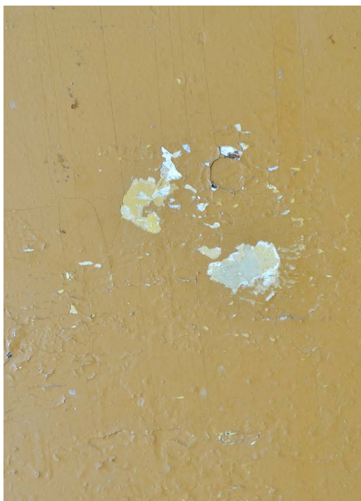
14. Färgskikt på södra verandans invändiga liggande panel, östra väggen. Under den mörkt gula syns ljus gul och ljus grå kulör. (SLM D2021-0861).
