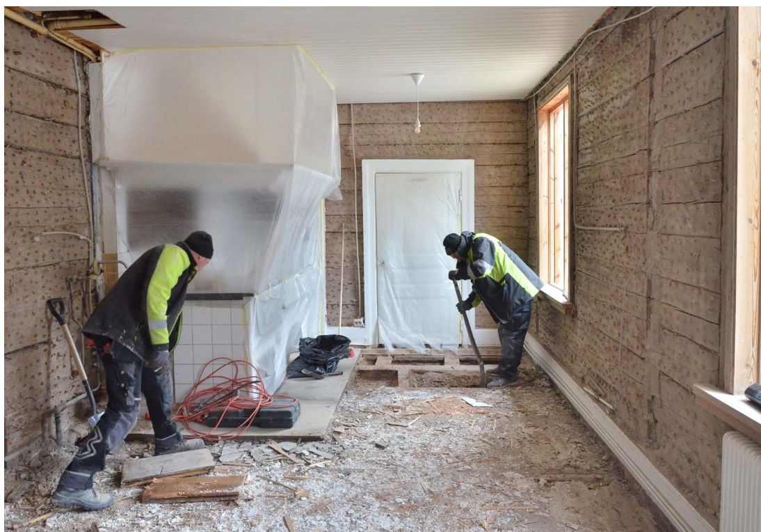
Bild 36. Köket, rum 1:6, efter läckan då fuktigt byggmaterial togs bort. Sett mot öster och den murade spisen. Alla puts på väggarna hackades ned och all isolering i bjälklaget togs bort. (SLM D2022-0880).
