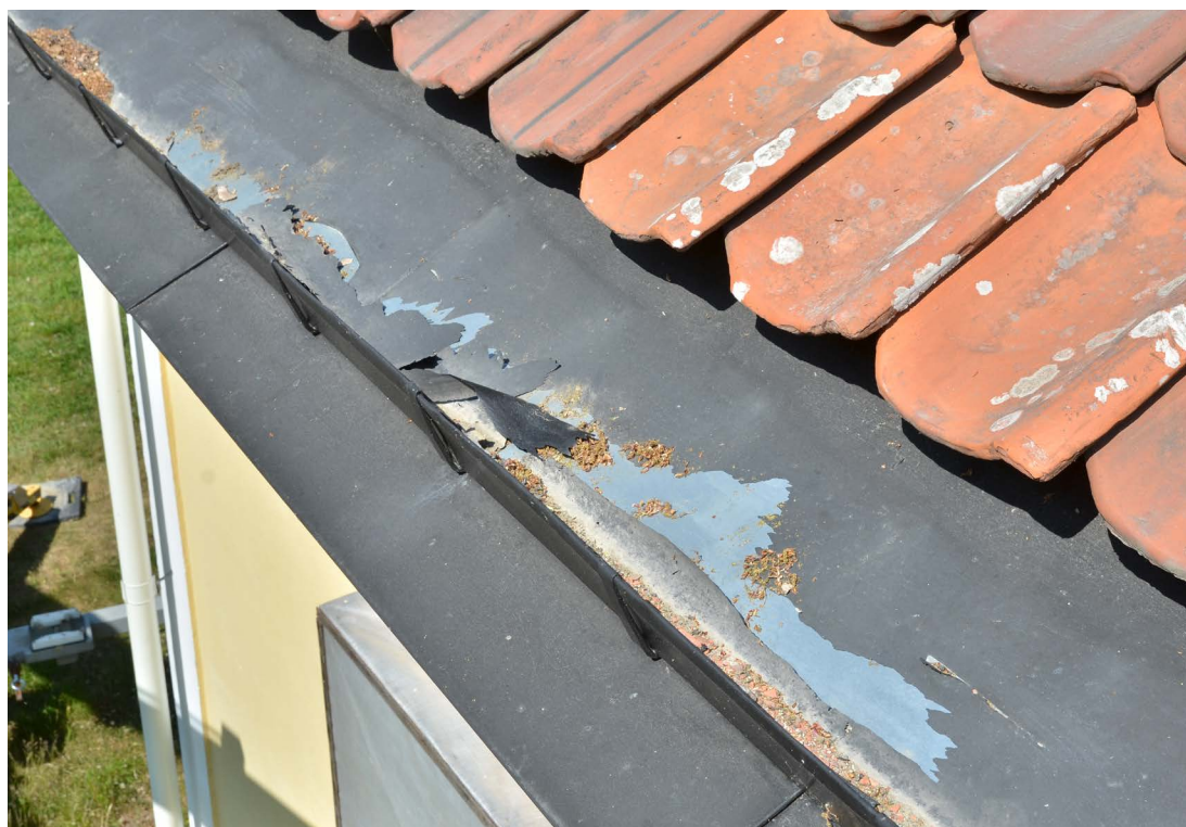
Bild 47. Vid den femte efterbesiktningen den 6 juni, hade redan fotrännans målarfärg släppt i stora sjok. Arbeten gjordes om, då lös färg togs bort och ytorna målades om. (SLM D2023-0555).
