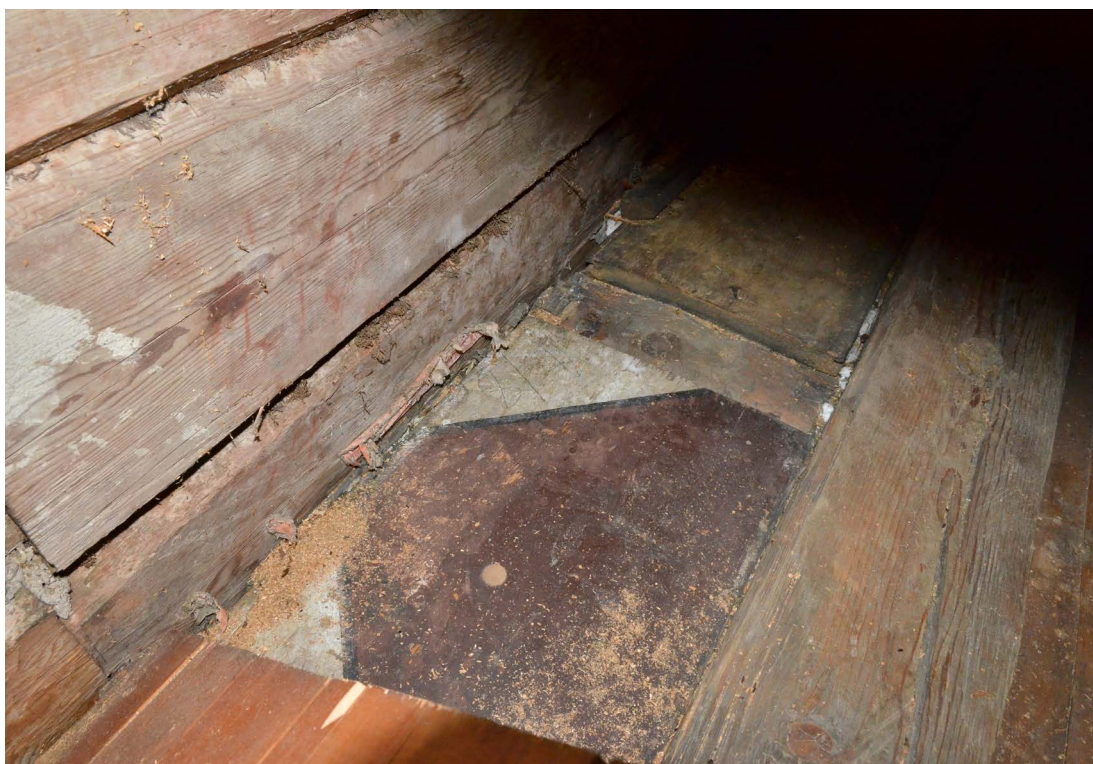
Bild 44. Spår av äldre golvbemålning på en av kattvindarna. (SLM D2022-0888).
