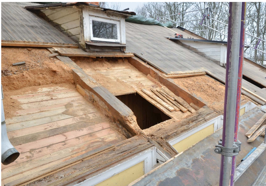
Bild 19. Del av södra takfallet, östra delen, innan lagning av rötskador. Taket var isolerat med sågspån. (SLM D2022-0866).
