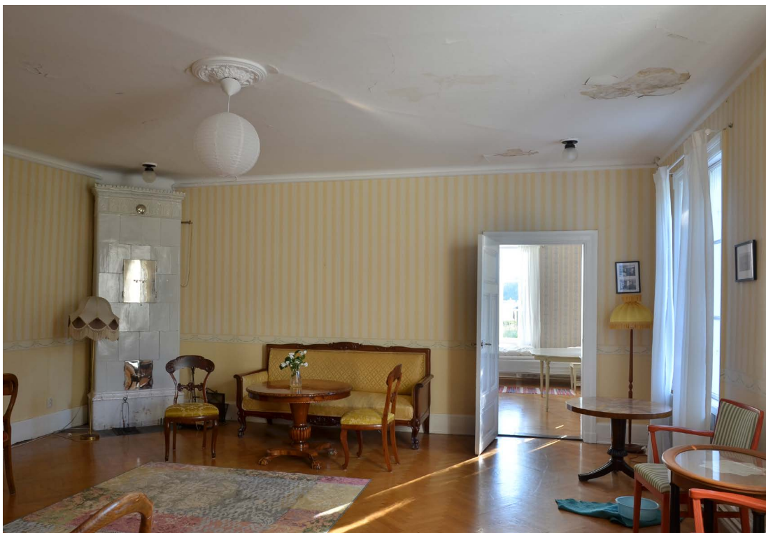
Bild 12. Salen, rum 1:15, på bottenvåningen vid husets nordvästra del. Innertakets puts och målning har skador från takläckaget. (SLM D2022-0859).
